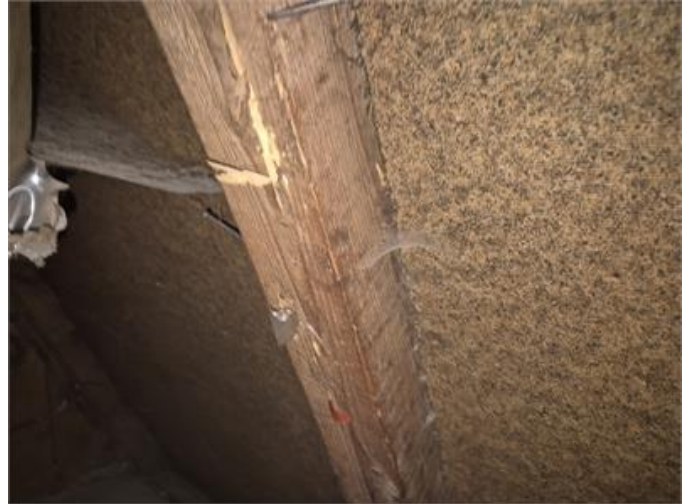
Angrepp av träskadeinsekt i taksparre sidvind.
