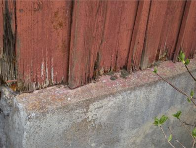
Det förekommer rötskador i vägg/syllbalkar närmast sockel.
