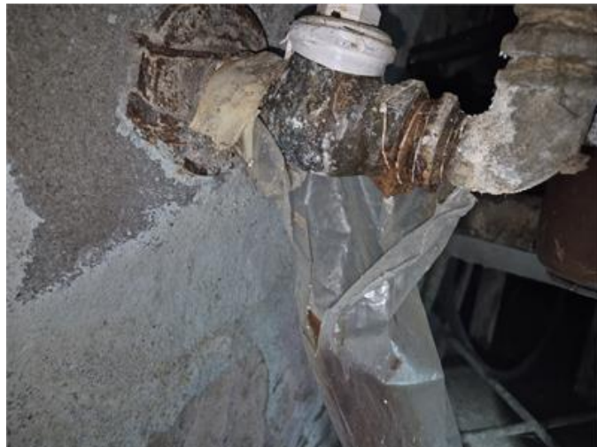
Rost/läckage på vattenledning/koppling i källaren.
