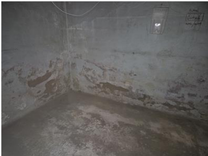
Hög fukt indikerades mot källarväggar.
