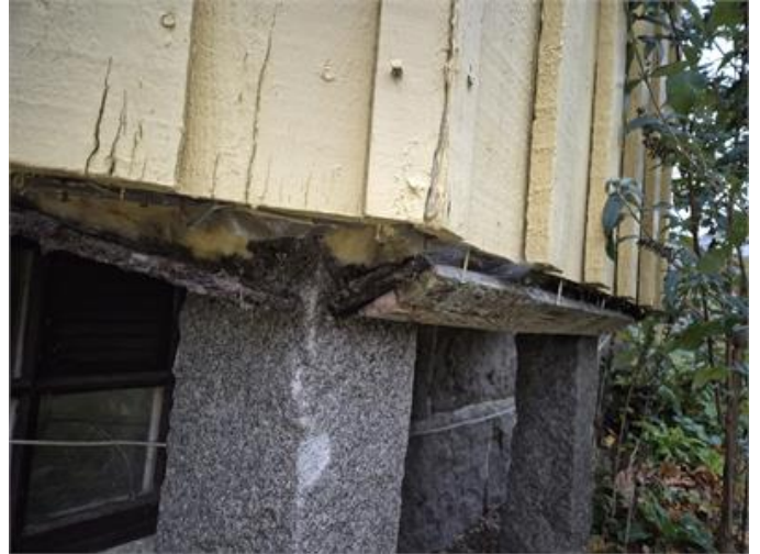
Trossbotten har delvis lossnat under burspråk.
