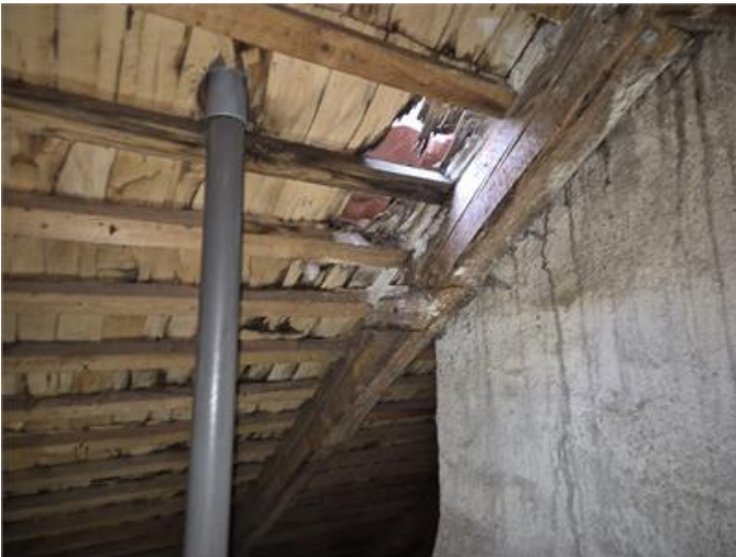
Dagsljus ses genom yttertak från vinden.
