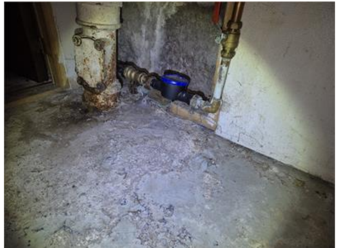
Hög fukt mättes i regel till utreglad vägg i källaren.
