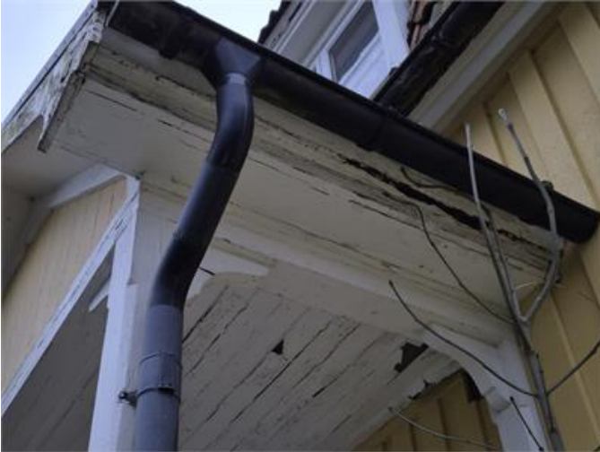
Omfattande fukt/rötskador förekommer i entréveranda.
