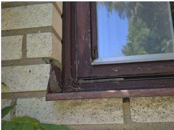
Fönsterparti med renoveringsbehov, lokal rötskada i list.
