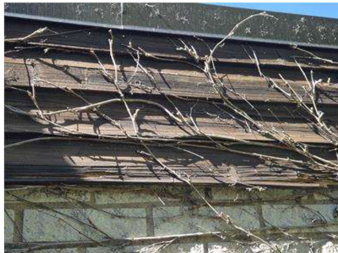
Rötskador förekommer i en del taksargsbrädor.
